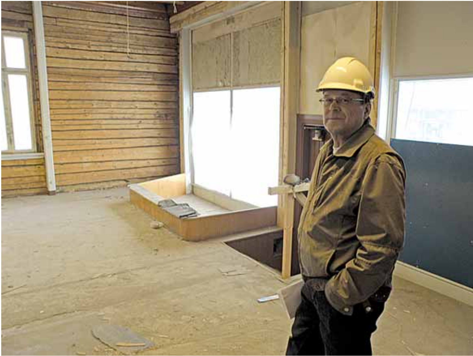
Rakennuttajarakennusmestari Nestori Horilan mukaan Bäckmanin kiinteistöstä ei ole löytynyt ikäviä yllätyksiä.
