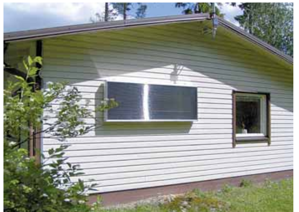
SolarVentin ilma-aurinkovaraajan paneeli on asennettu aurinkoisimpaan paikkaan mökin eteläseinään. Sisällä mökissä on venttiili ja termostaatti.
