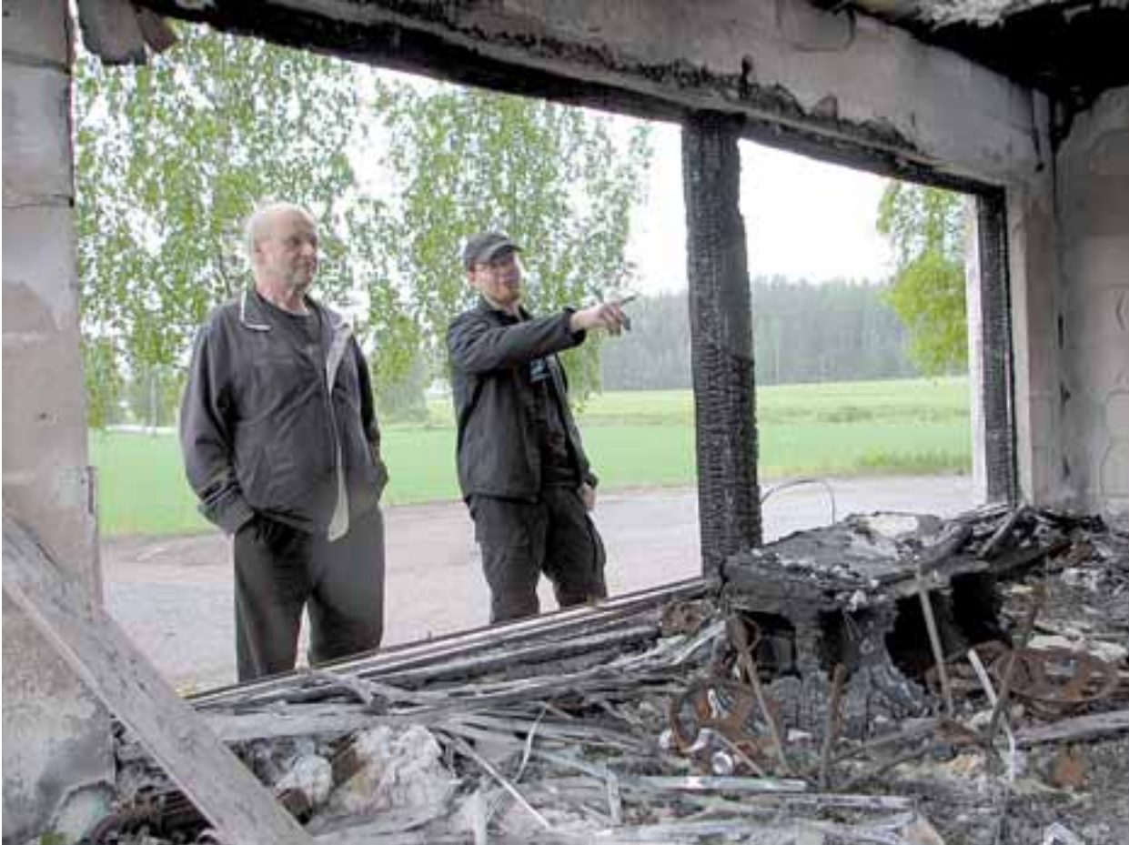
Putajan Ponsi -yhdistyksen jäsen Erkki Vuorinen (vasemmalla) ja puheenjohtaja Tero Vuorenniemi ovat huolissaan rakennuksen romahtavasta katosta sekä tontille rikotuista ikkunanlaseista ja pulloista.
